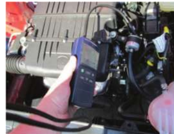
Испитивање уградње уређаја и опреме за њон возила на течни нафтни гас ТНГ
